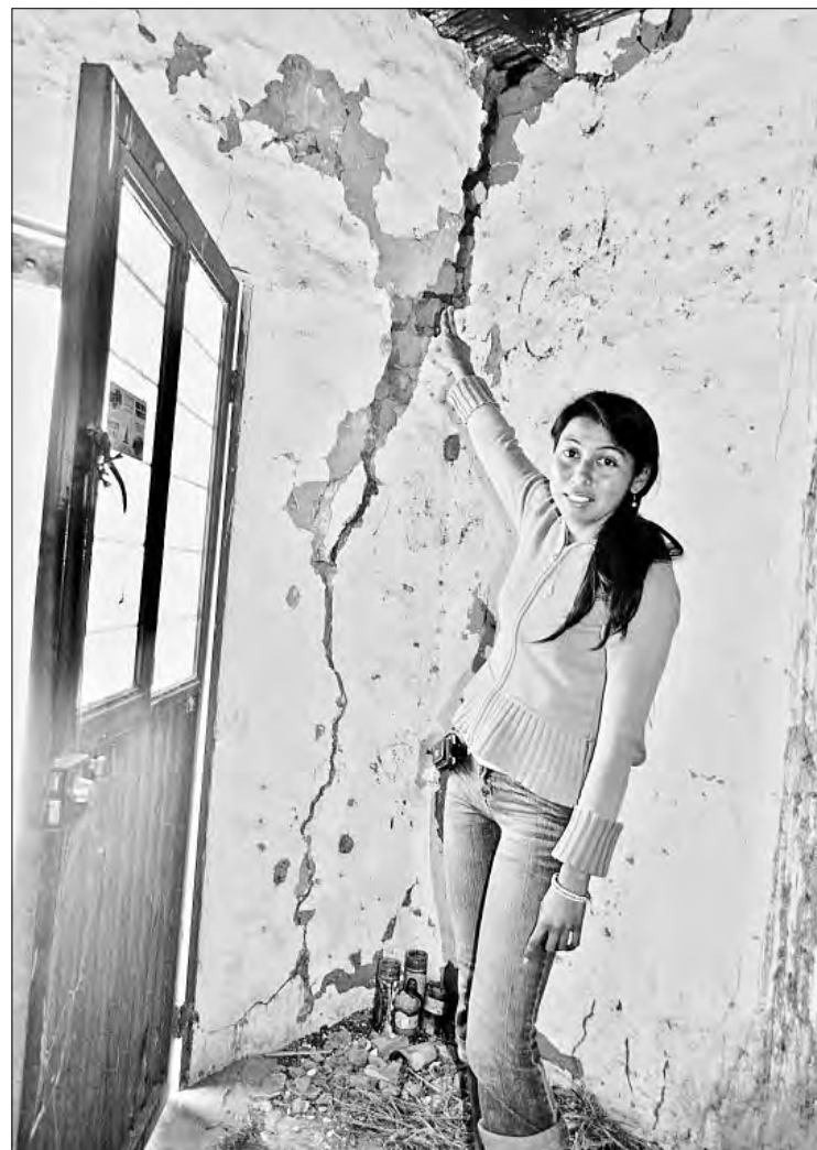
▲ Argelia Sanjuanita, habitante del ejido Las Enramadas, de Los Ramones, Nuevo León, muestra los daños en su casa provocados por el fracking. Foto Sanjuana Martínez
