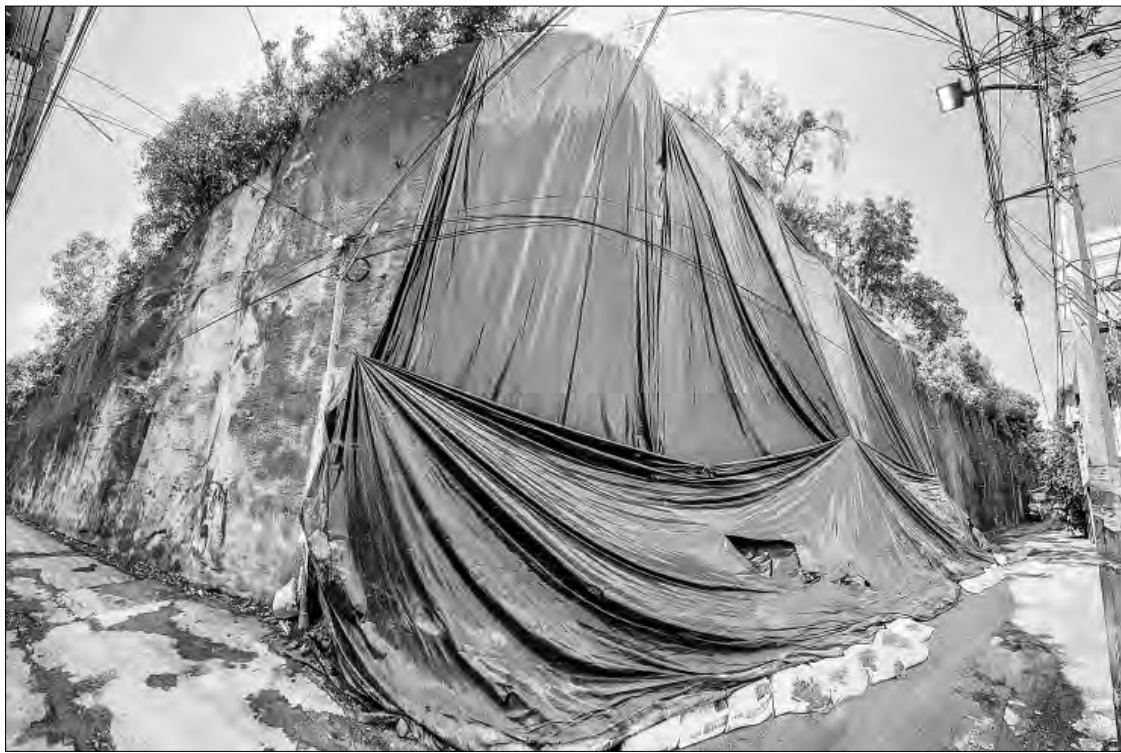
▲ Lonas negras y costales rellenos con arena son el sostén del talud de la calle Esteban Flores, el cual en noviembre del año pasado sufrió un deslizamiento de 150 metros cúbicos de tierra que
