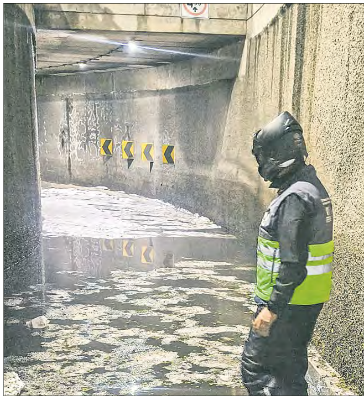
▲ El paso a desnivel en Vista Hermosa se inundó. Foto La Jornada
