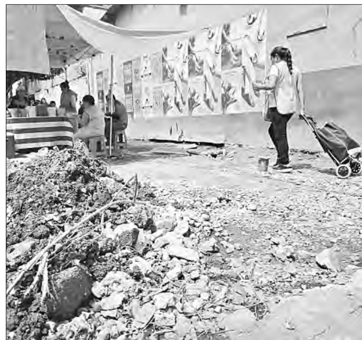
▲ En calles de la alcaldía Cuauhtémoc los trabajos de repavimentación y mejoramiento de vialidades han quedado inconclusos en algunos puntos, los cuales, además de dejar el suelo irregular, acumulan cascajo, raíces y lodo. Foto Mara Ximena Pérez
