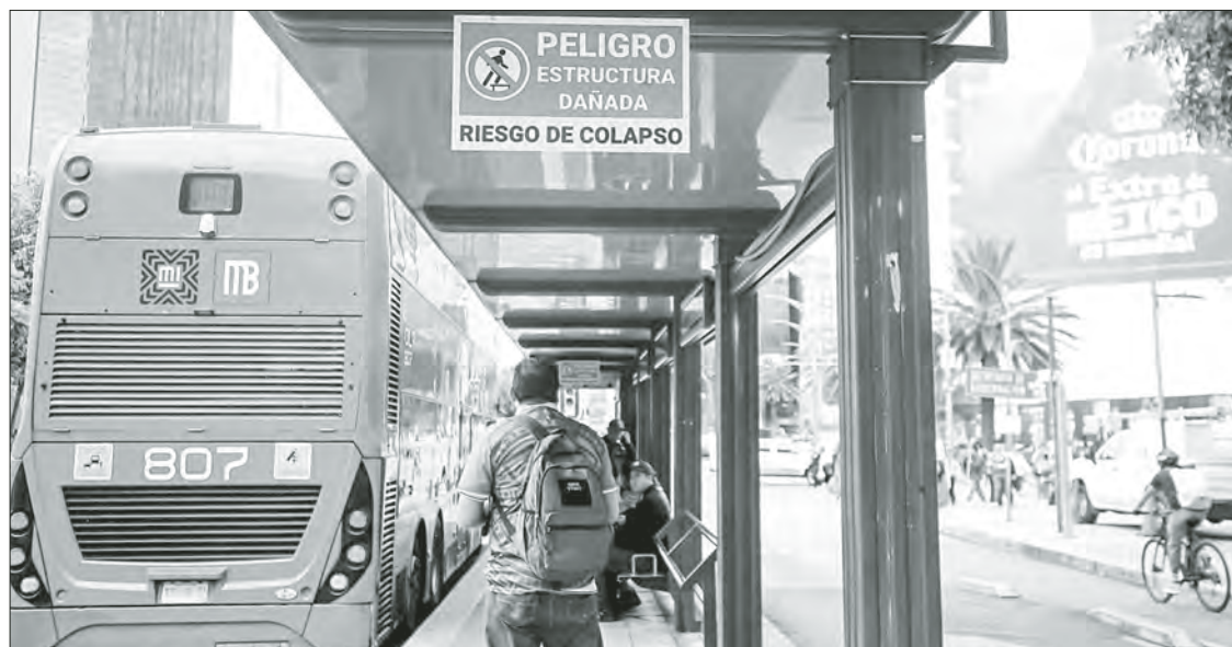
▲ A pesar de que las estaciones Chapultepec, La Diana, El Ángel, El Ahuehuate y El Caballito tienen cintas amarillas de precaución y letreros en los que se advierte del riesgo de colapso por estructura
