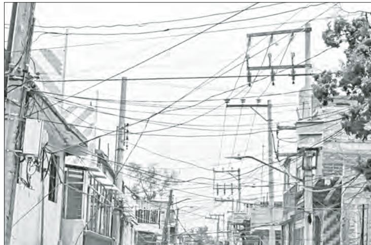
◀ Como una telaraña, el cableado obsoleto en las calles de la capital crea un obstáculo para peatones y vehículos, además de que genera contaminación visual. Foto Mara Ximena Pérez
