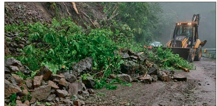
▲ Los trabajos para la reconstrucción del puente Garcés, afectado por las lluvias de octubre, se han detenido debido a las condiciones climáticas, informó el diputado Julián Nochebuena Hernández. Foto Especial
