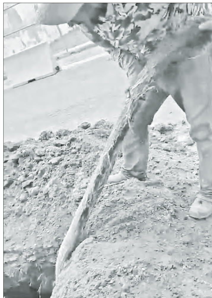
▲ Trabajadores del Sistema Municipal de Agua Potable, Alcantarillado y Saneamiento retiraron ayer una raíz de 21 metros de una tubería en la calle Gustavo Díaz Ordaz, en Ecatepec, la cual provocó escasez de agua potable en el área. Foto captura de pantalla de video
