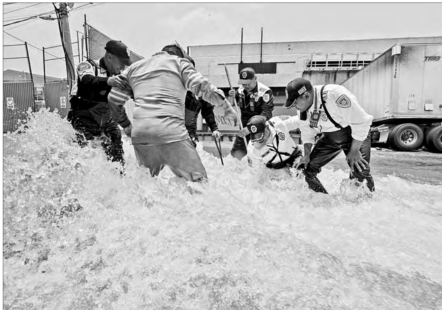
◀▶ Tras la rotura del tubo que provocó la megafuga, cuadrillas de trabajadores de la alcaldía Iztapalapa, en coordinación con personal del gobierno central, laboraron para desalojar el agua y levantar el censo de daños. Foto Alfredo Domínguez
