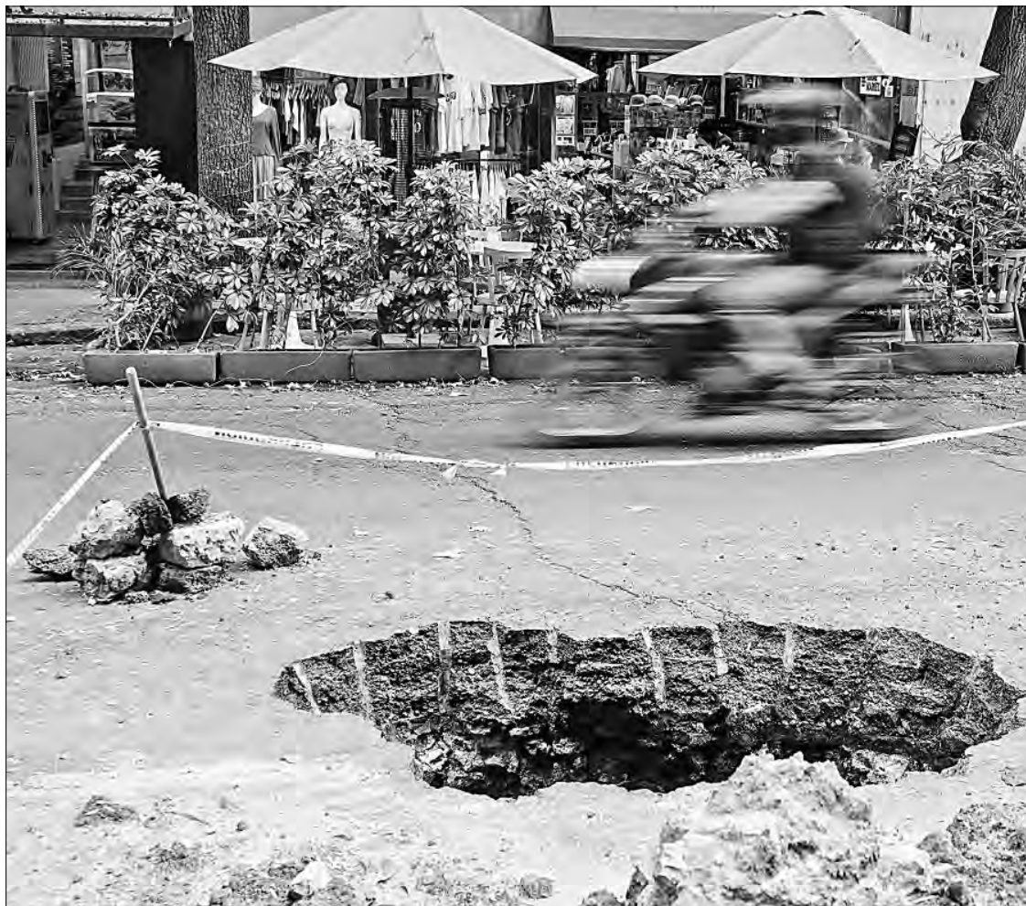
▲ La aparición de socavones en la Ciudad de México no se hicieron esperar tras las recientes e intensas lluvias, lo que representa un riesgo para la
