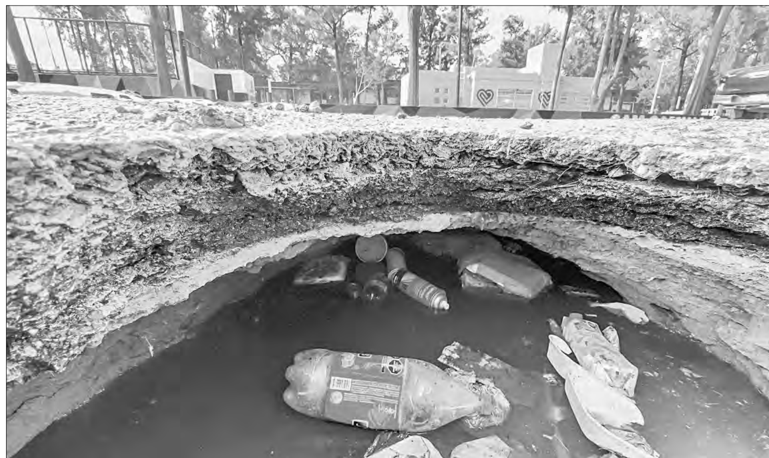
◀ Entre las calles Fresnillo y Emiliano Zapata, un socavón ha aumentado la preocupación de los vecinos, debido a que la atención por parte de la alcaldía ha sido nula. Foto Jair Cabrera Torres
