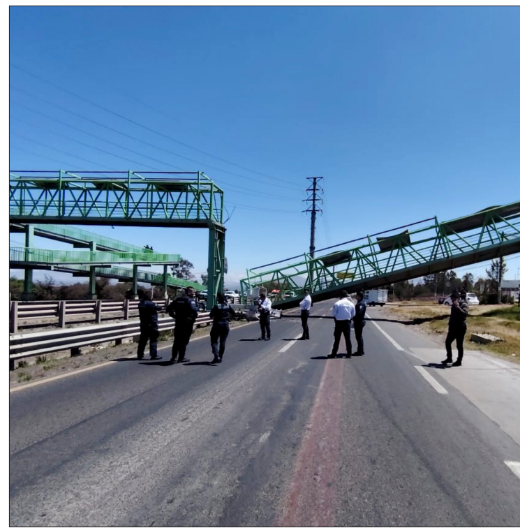
▲ La caída parcial del puente generó el cierre de la circulación en un sector de la carretera. Foto Nathali González
